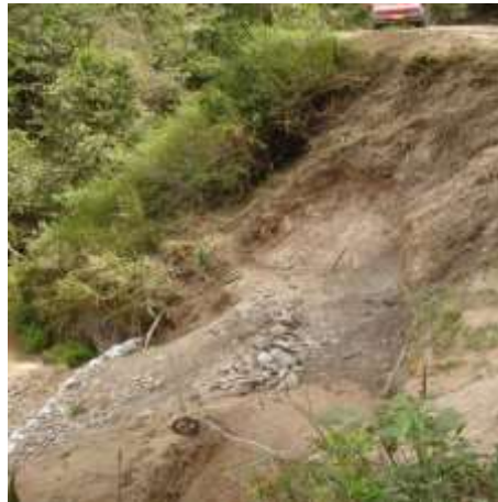
Figura 6 PR 64 + 950 deslizamiento material
