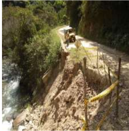
Figura 2 Pérdida de banca existente
