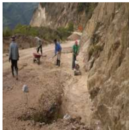
Figura 5 PR 54 + 100 socavación y pérdida de finos
