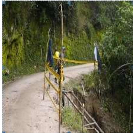
Figura 3 Pérdida ancho de calzada
