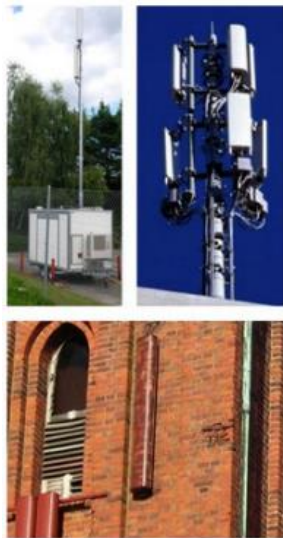
Figura 10 Antenas de transmisión y recepción en red celular. Tomada referencia (Casademont, 2010)
