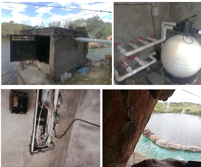
Figura 19. Mal estado de tableros de control de bombas e instalaciones inadecuadas de tomas eléctricas
