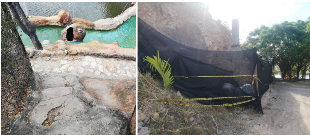
Figura 14. Escaleras en mal estado y falta de señalización inadecuada de áreas de trabajo
