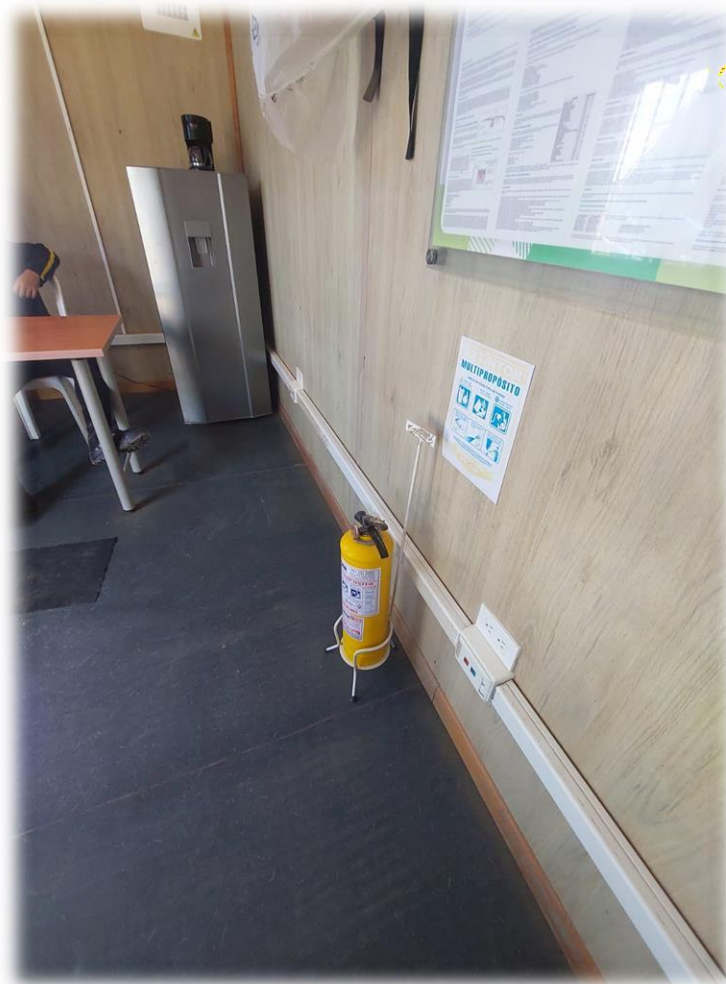
Ilustración 4: Extintor ubicado en bascula, es el más cercano al almacén de sustancias químicas - Parque Ambiental Andalucía
