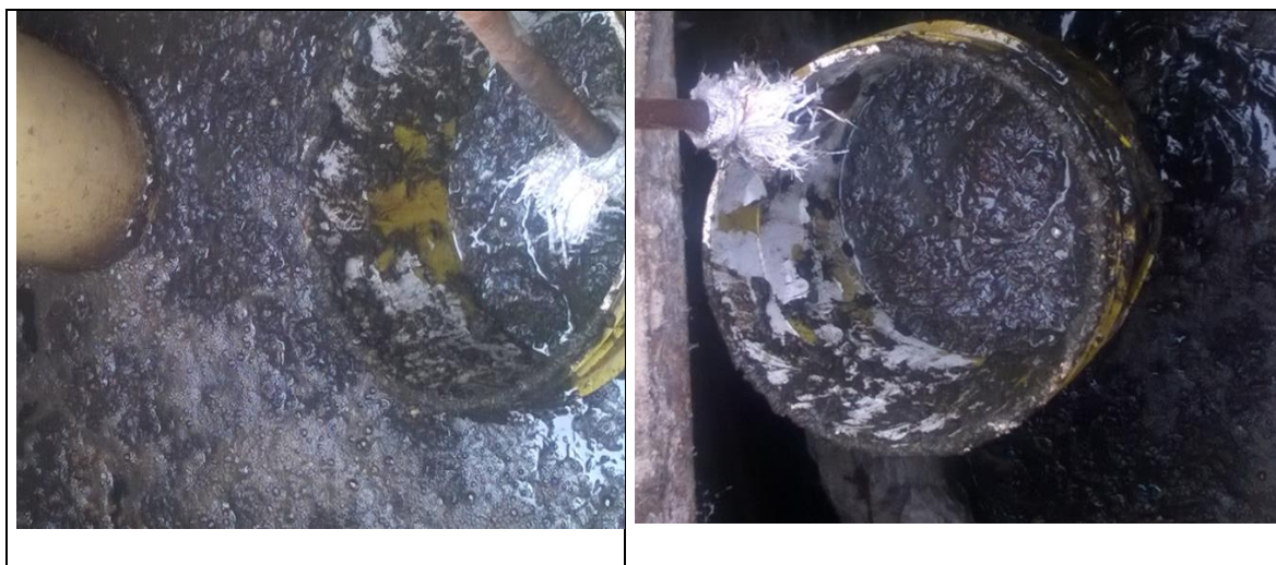
Figura 5. Agua residual del pozo séptico
