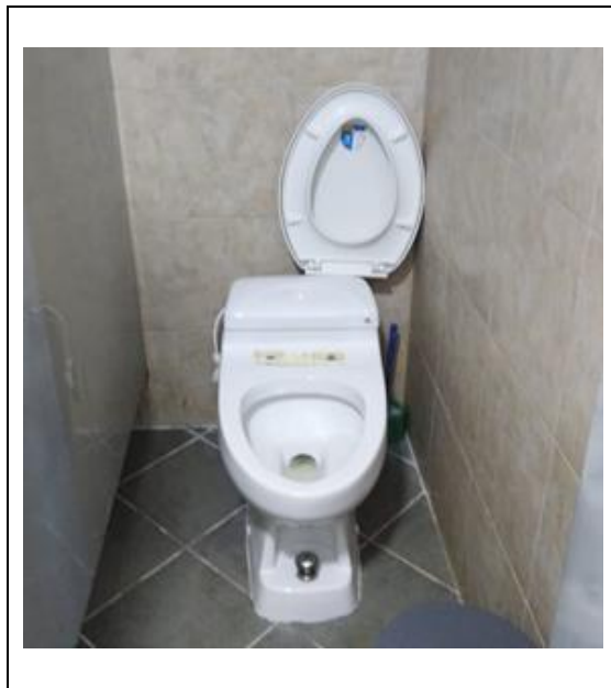
Figura 13 Fotografía batería sanitaria en mal estado
